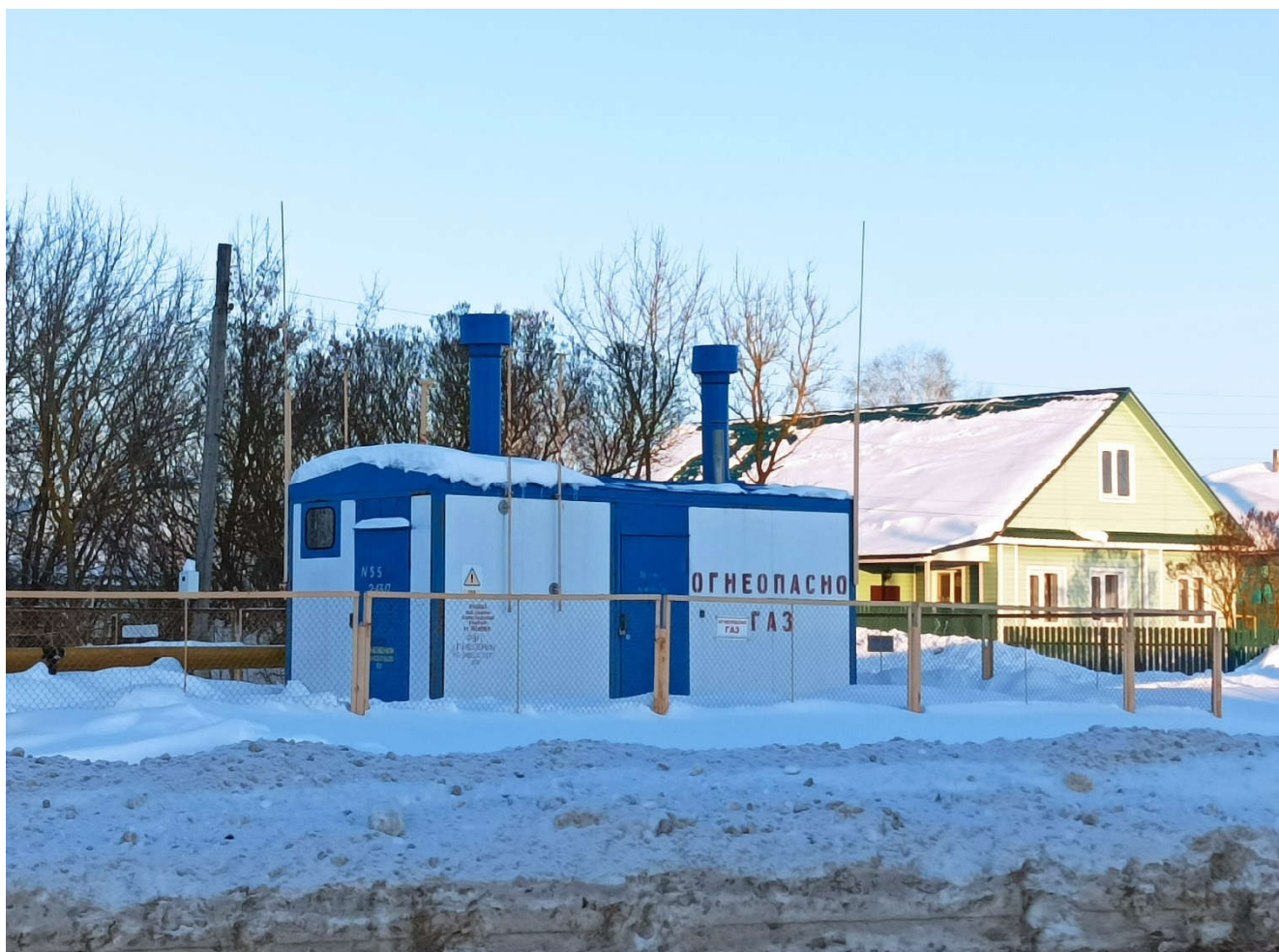
(рис.1) Газораспределительная станция на улице Советской
