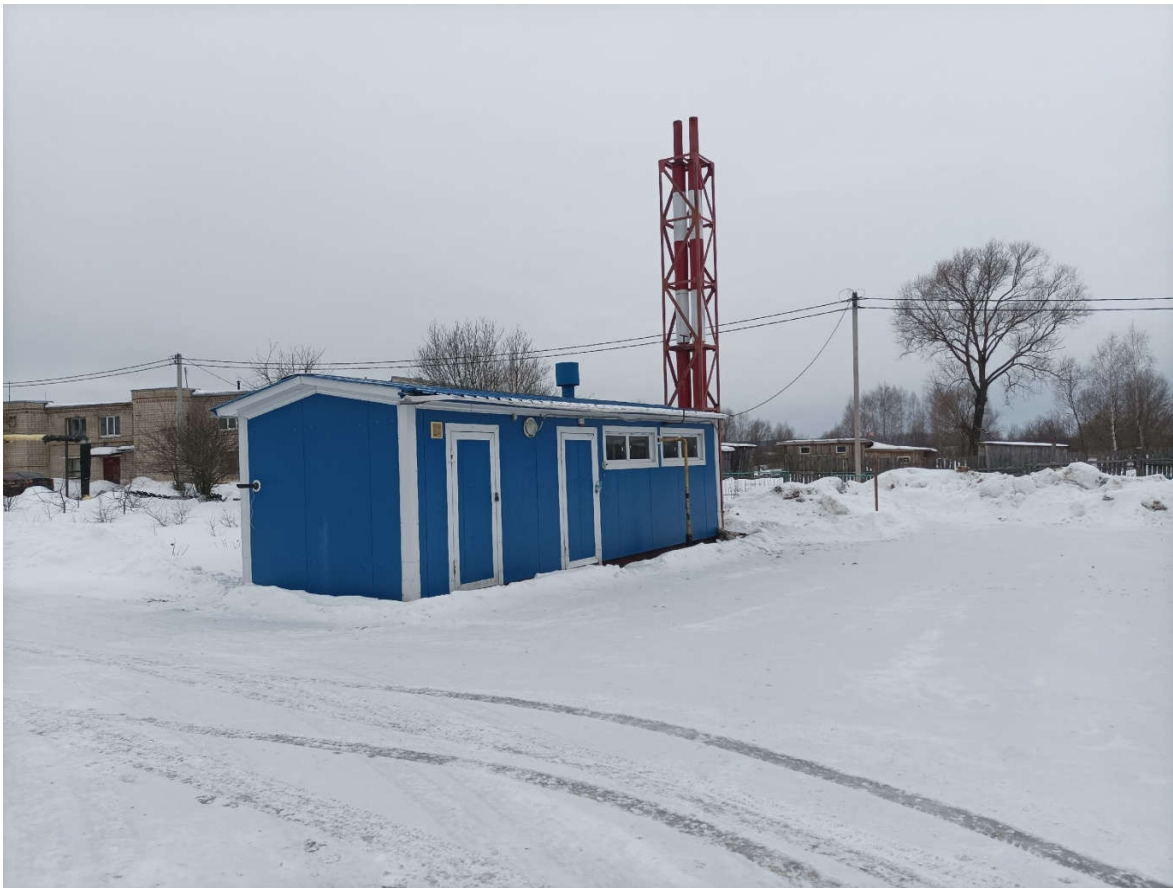
(рис.3) Газовая котельная на улице Садовой
