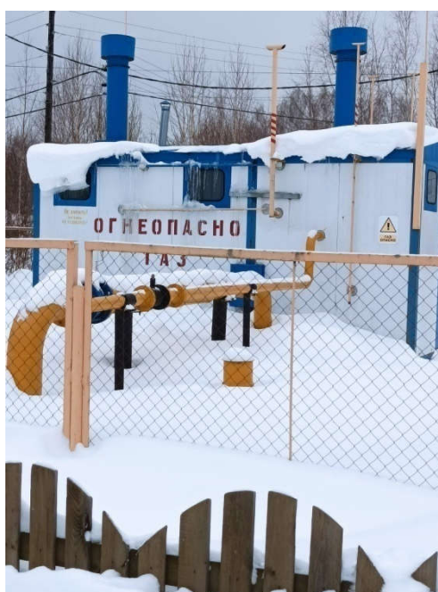
(рис.2) Газораспределительная станция на улице Садовой
