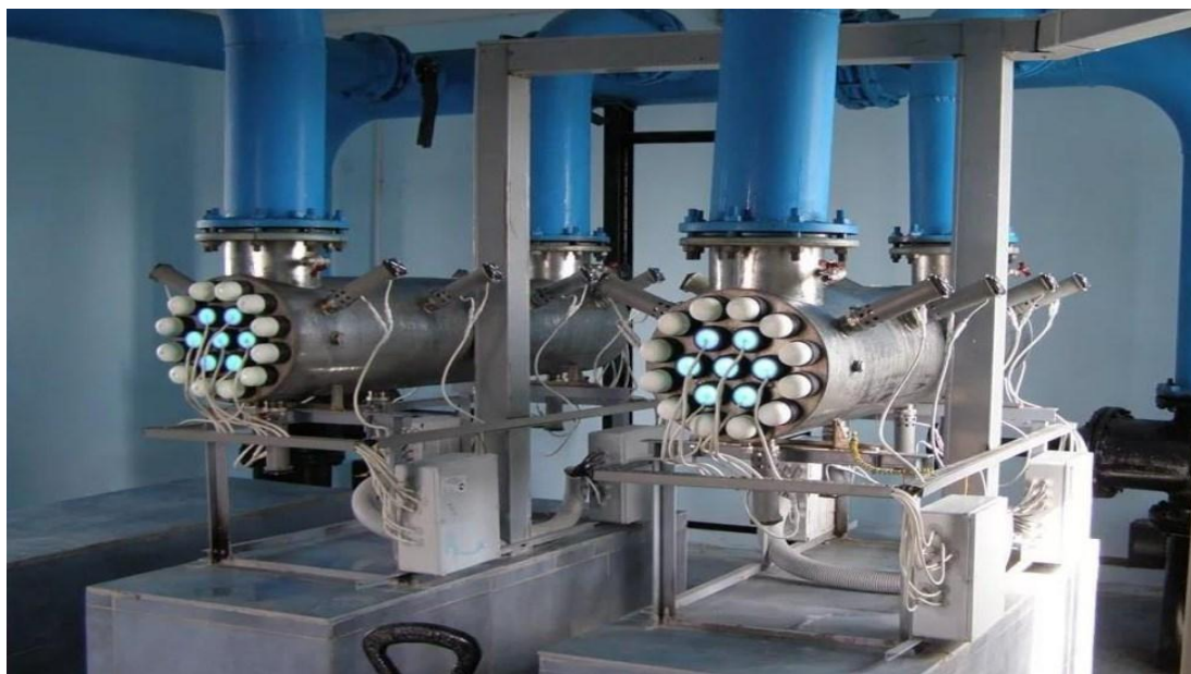
Рис. 4. Установка с лампами УФ-обеззараживания сточных вод
